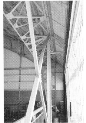
写真14 座屈した桁ブレース
