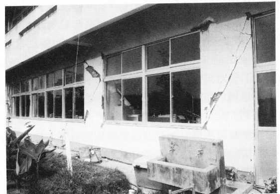
写真2 南構面の被害状況
