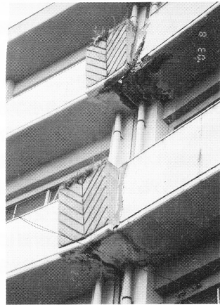
写真10 Exp.Jointの被害状況
