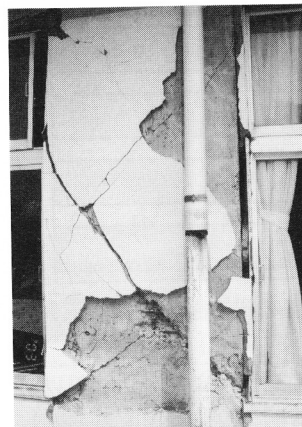
写真3 せん断破壊した柱
