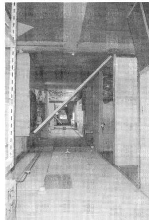
写真5 転倒した防火扉
