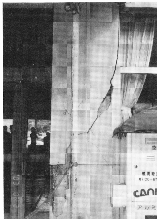
写真11 せん断破壊した柱（小野小学校）
