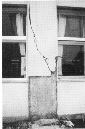
写真20 南側構面の柱のせん断ひび割れ (校舎①-1)
