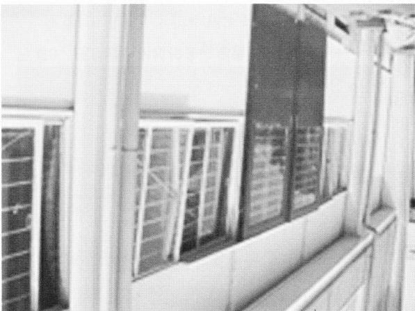
写真7 開口部・窓ガラスの損傷
